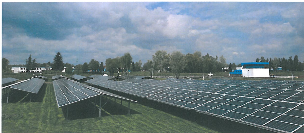
Instalacja fotowoltaiczna zlokalizowana na terenie Zakładu Uzdatniania Wody przy ul. Zwiączyckiej w Rzeszowie
